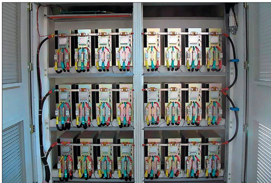
Рис. 4. Шкаф инвертора с блоком силовых ячеек
