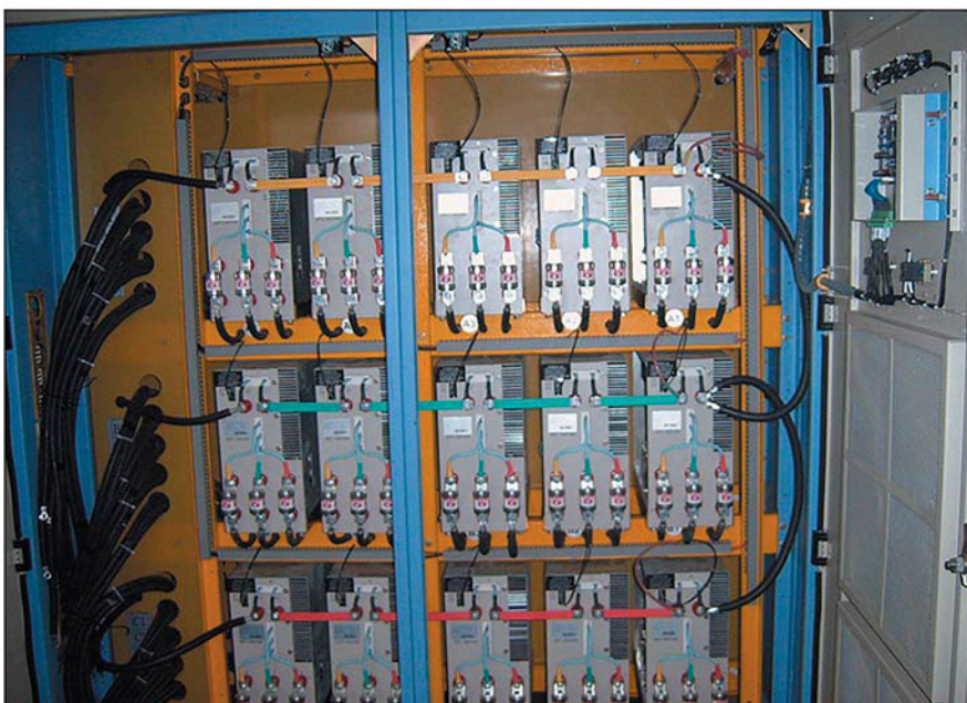
Рис. 11. Шкаф инвертора с подключенными последовательно силовыми ячейками
