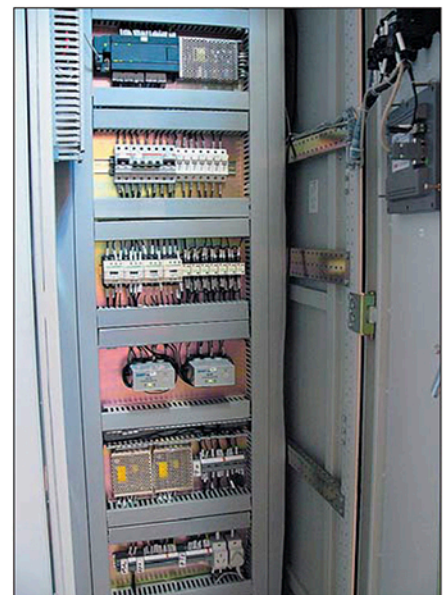
Рис. 5. Шкаф контроллера управления
